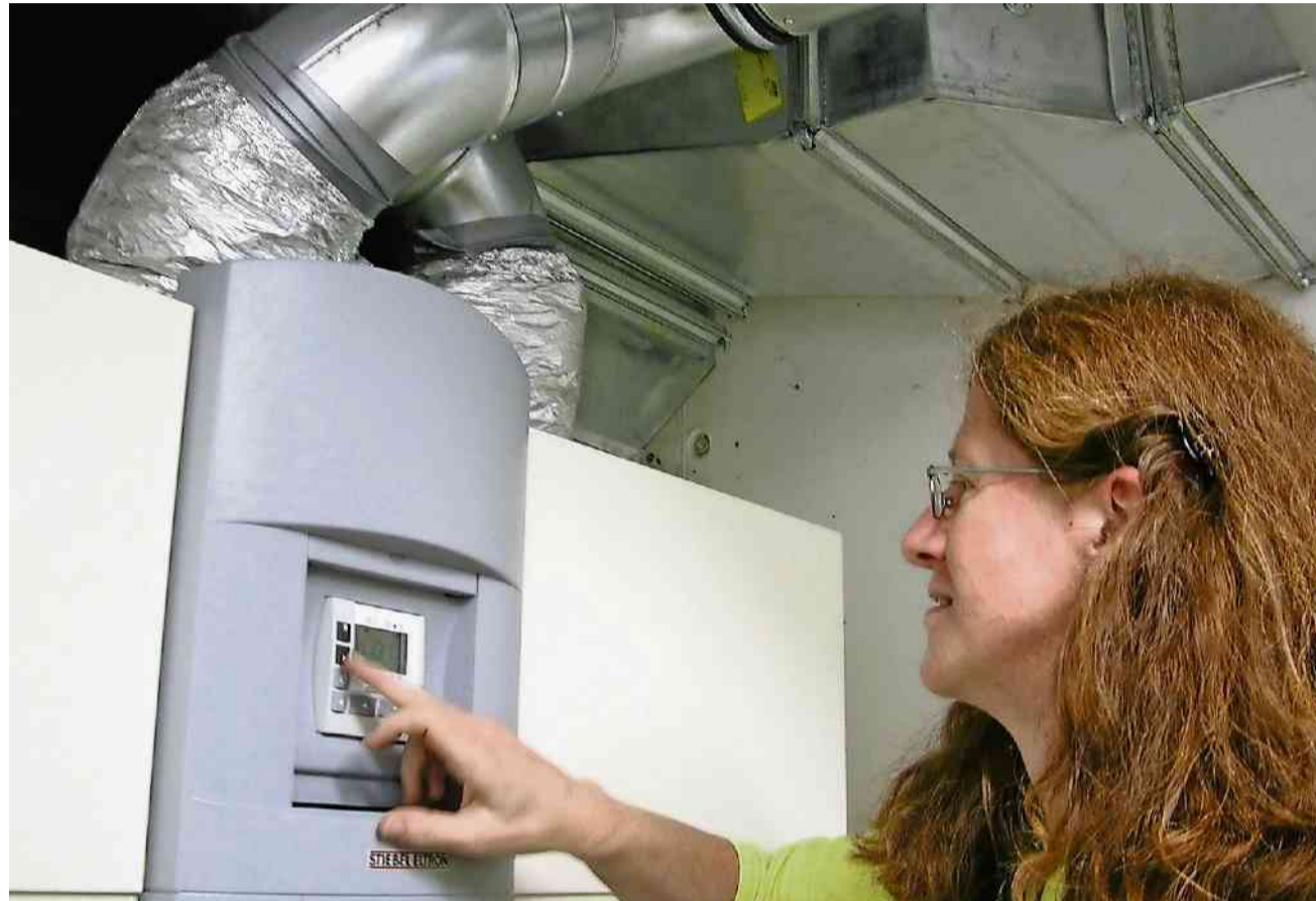
Erd-Wärmepumpe statt Öl- oder Elektroheizung: Unter anderem solcher Ersatz wird vom Energiepaket gefördert. SYMBOLBILD AZ
