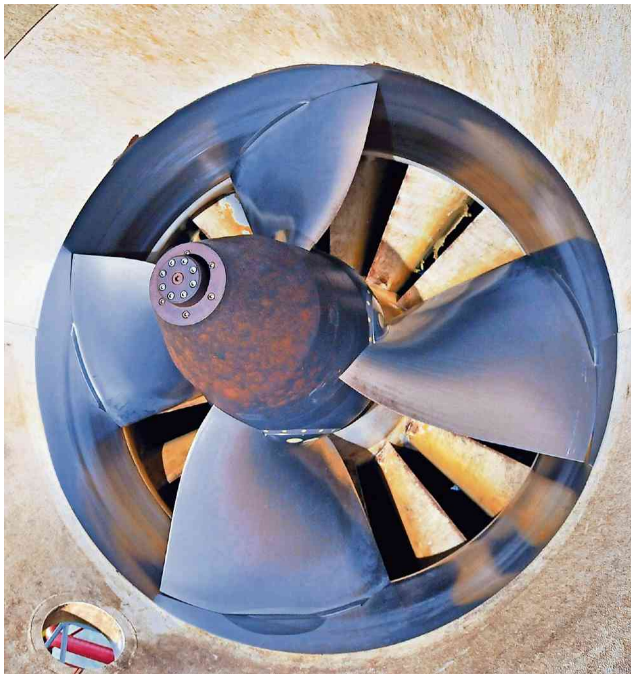
In den Solothurner Wasserkraftwerken stehen derzeit viele Turbinen still. Der Grund ist die lang anhaltende Trockenheit – noch fehlt das Wasser. OLIVER MENGE
