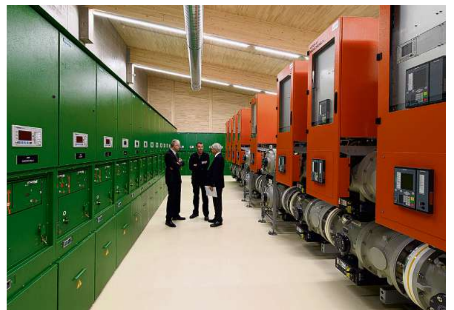
Leistungsfähiger Leitungsknoten. EBM-Chef Konrad Ammann (rechts) weiht das neue Unterwerk in Aesch ein. Foto Dominik Plüss
