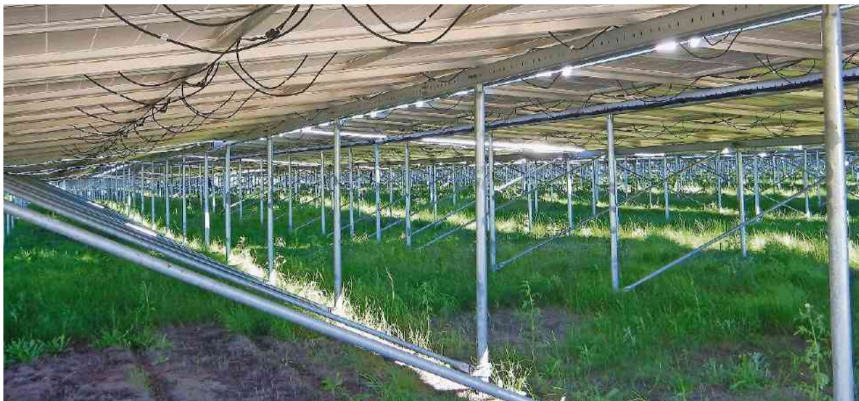
Die Pfähle, auf denen die Solarpanels montiert sind, wurden – ähnlich wie Slalom-Stangen im Schnee – ohne Betonfundament direkt in den Boden geschraubt. So bleibt nach dem Abbau nichts zurück.
