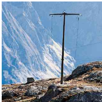
Beschädigter Strommast nach der Kollision auf dem Gotthard. Keystone
