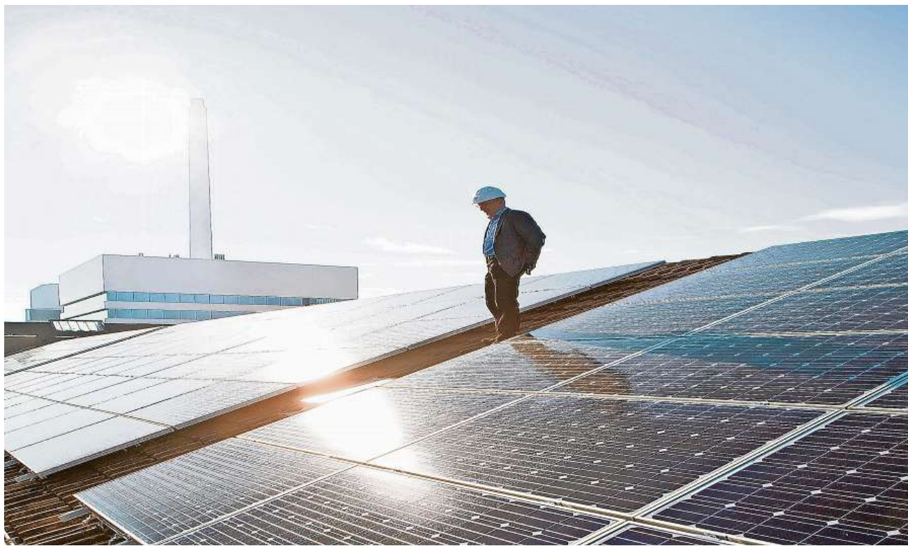
Bald auf jedem Dach? Die Regierung muss prüfen, ob Hauseigentümer Solaranlagen montieren müssen. Foto Henry Muchenberger
