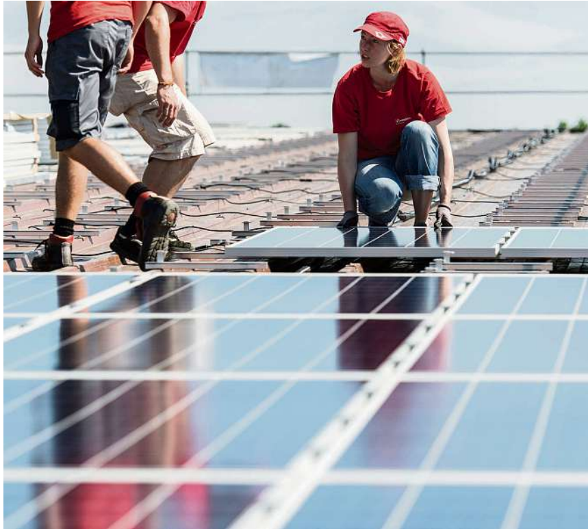
Energiebedarf und Emissionen halbiert. Die Solarmodule werden immer dünner, gleichzeitig steigt ihr Wirkungsgrad.
