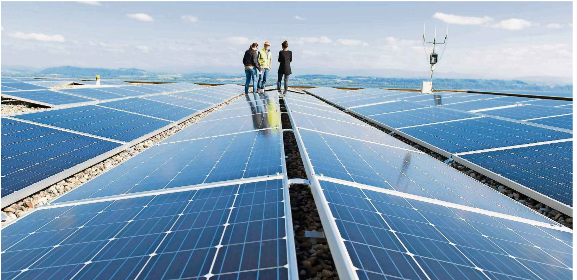
Rentieren heute auch ohne staatliche Zuschüsse: Photovoltaik-Anlagen, hier auf einem Schuldach in Neuchâtel.
